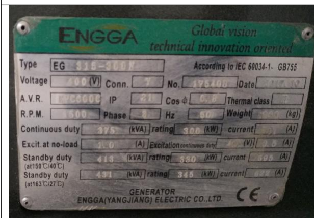
图 8-3 备用柴油发电机铭牌（300kW）
